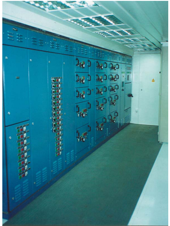
Widok elewacji rozdzielnicy 400/231V panelowo-kasetowej dla odbiorów technologicznych. Odbiory dużej mocy są umieszczone w kasetach wysuwanych (w środku rozdzielnicy), małej mocy na płytach montażowych (z lewej strony zdjęcia).
