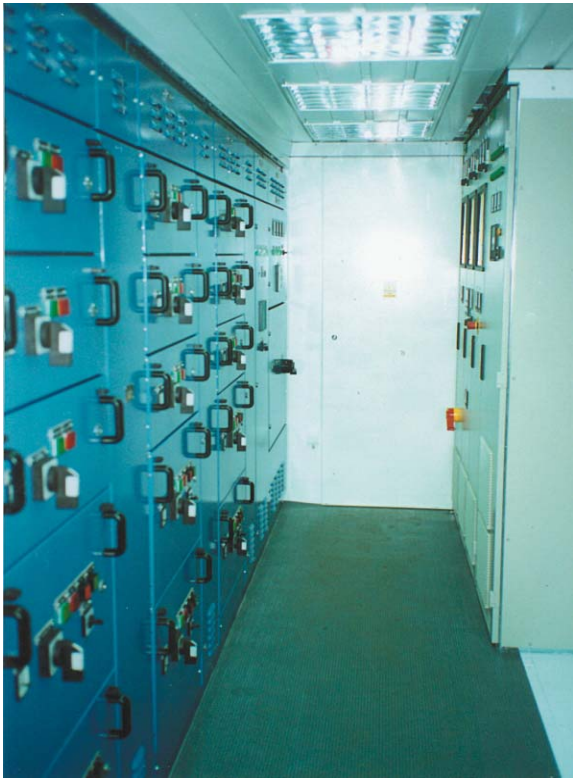
Widok rozdzielnicy 400/231V panelowo-kasetowej dla odbiorów technologicznych o mocy do 75kW wraz z 6 stopniową baterią kondensatorów 275kVar (z lewej strony zdjęcia). Z prawej strony zdjęcia widoczna jest rozdzielnica 690V panelowa dla 6 silników z falownikami oraz 3 bateriami kondensatorów 600kVar.
